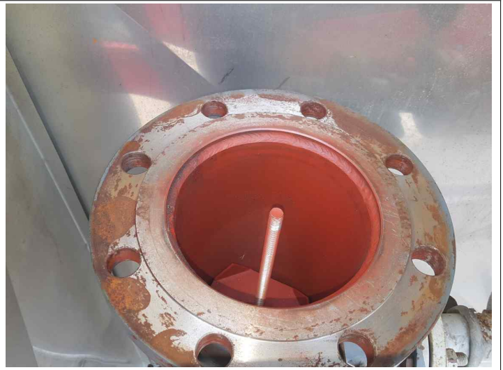
( FILTER 내부 이물질 제거 )
