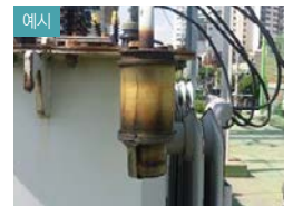
절연유 부적합 및 호흡기 파손 * 통전상태이니 절대 만지면 안됩니다.
